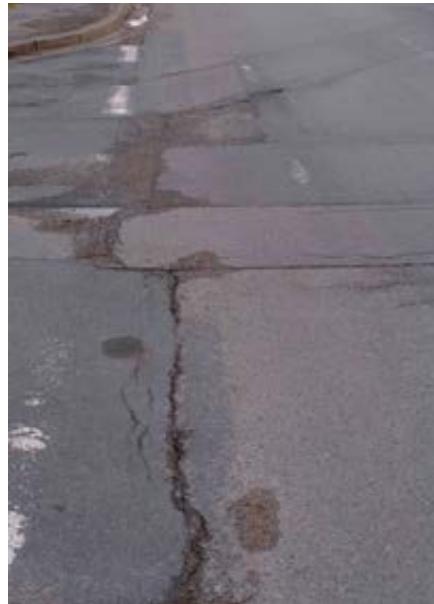
Auf Degerser Straße ist der Schutzstreifen fast weg – die Markierung ist abgefahren.
