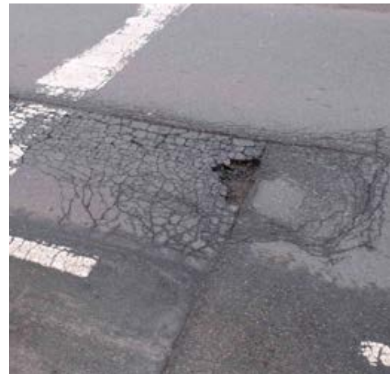
Fahrbahn der Degerser Straße ist stark sanierungsbedürftig.
